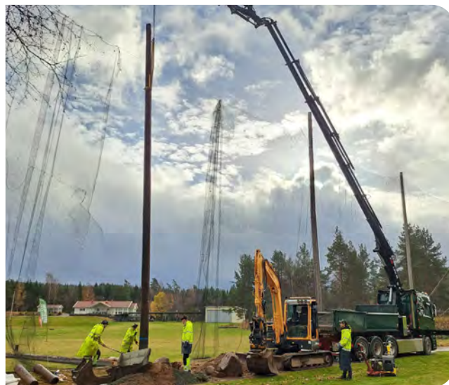
Åskväder och gamla stolpar på driving rangen orsakade problem under 2024.
